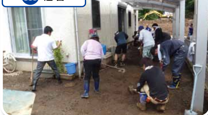
▲住宅の裏山からの土砂崩れで土砂の撤去作業
